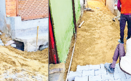
गन्नीौर। कच्ची मिट्टी में ही टाईलें बिछते हुए नगरपालिका टेकेदार के मिस्त्री।
